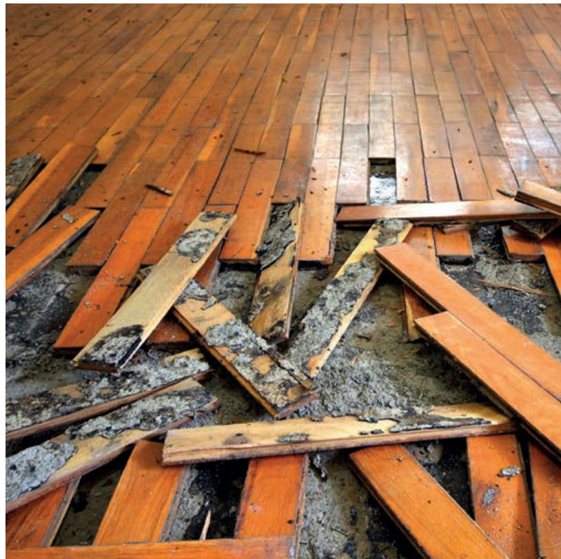
Abb. 48 – Schäden durch Stauwasser
